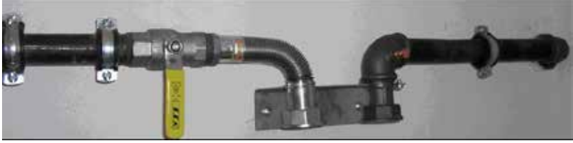
Şekil 26 Doğal Gaz Sayaç Montaj Yeri
